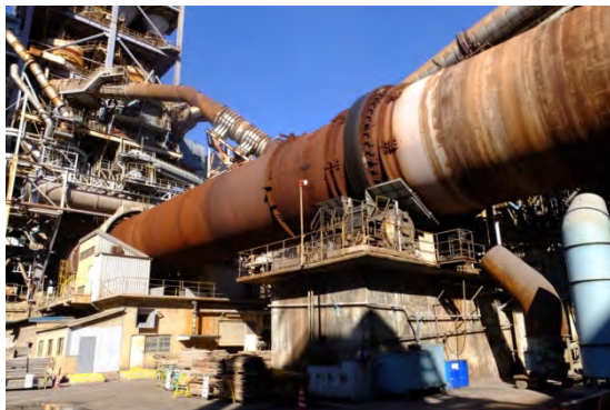
▲工場設備(焼成用キルン)
